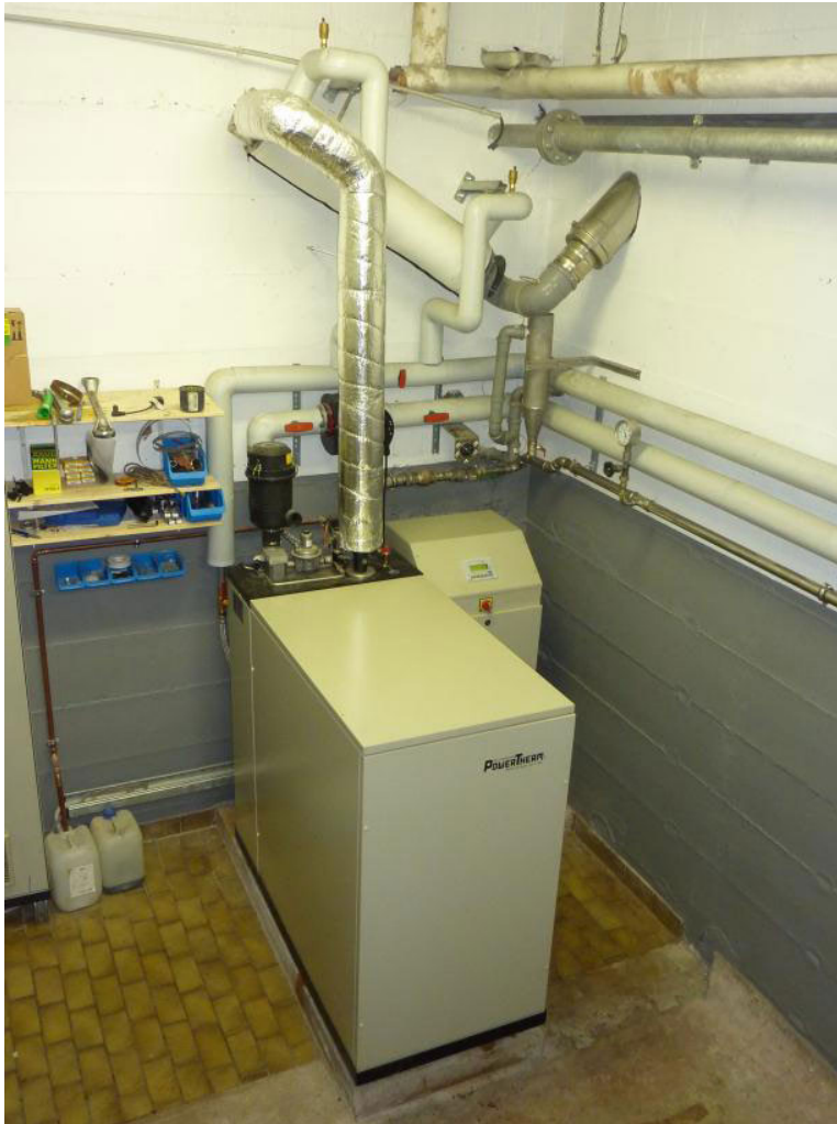
Bild 27: Gasmotor mit Brennwert-Wärmetauscher
